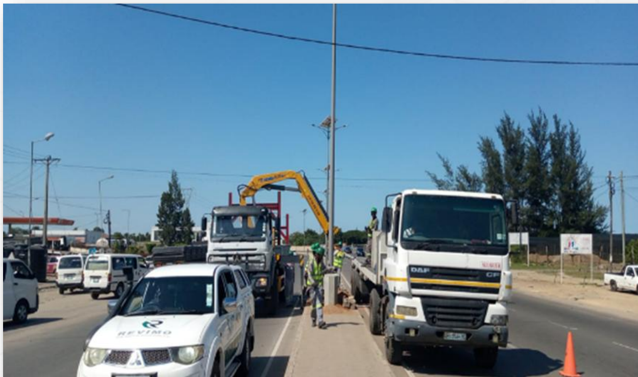
Figura 11 – Obras de Iluminação Pública nas Estradas Circular através de painéis solares / Figure 11 – Public Lighting Works on Circular Roads using Solar Panels
